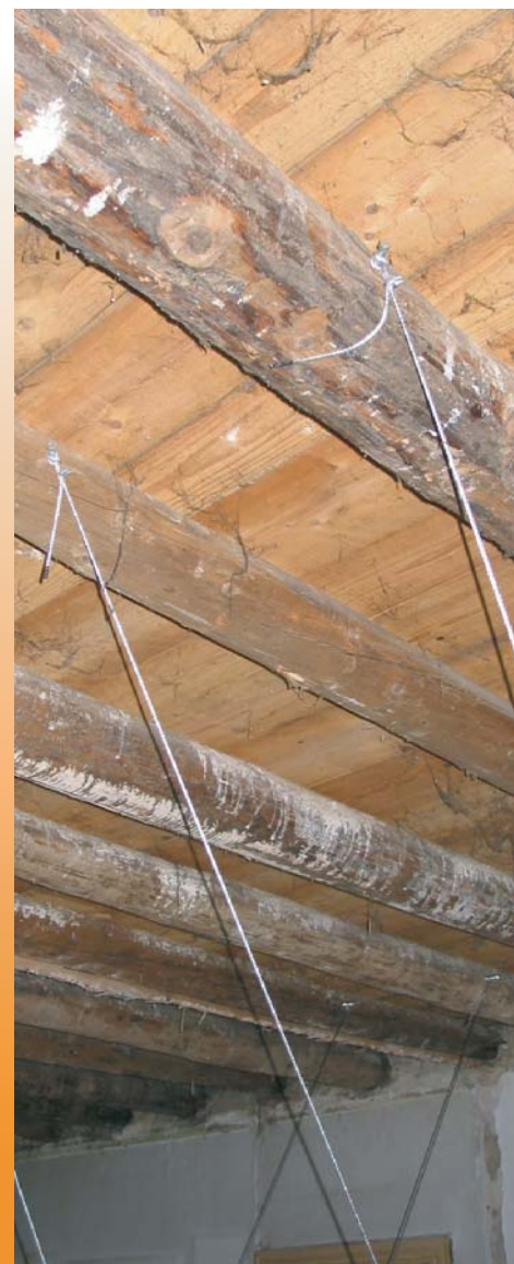
Particolare dell'aggrappo dei cavi in acciaio alle travi soprastanti tramite tirafondi infissi nel legno.
