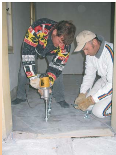
Quindi si procede all'avvitaggio dei tirafondi tramite avvitatore dotato di una buona coppia anch'esso messo a disposizione dall'azienda.
