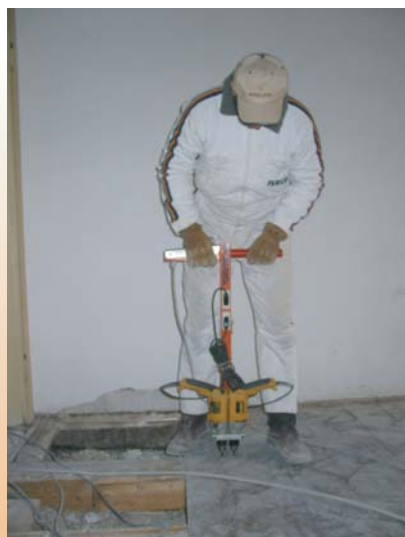
Dopo aver rimosso le piastrelle esistenti, si è messo a nudo il tavolato. Si è optato per il connettore tipo MAXI che viene posto direttamente sopra l'assito. Dopo aver segnato il passo di posizionamento è stato steso un telo di nylon e si è provveduto alla doppia preforatura del legno tramite attrezzo dato in dotazione da Tecnarìa.
