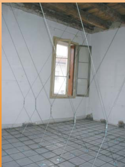
I tiranti di acciaio sorreggono le parti in mezzeria del solaio ed si aggrappano alle travi in corrispondenza degli appoggi in alto.
