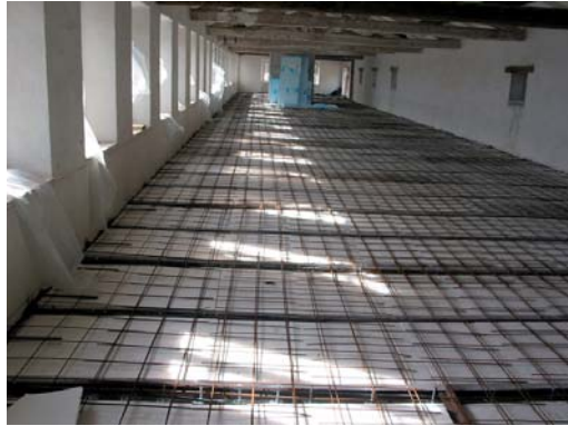
Il solaio con connettori fissati, isolante e rete elettrosaldata, pronto per il getto di calcestruzzo.
