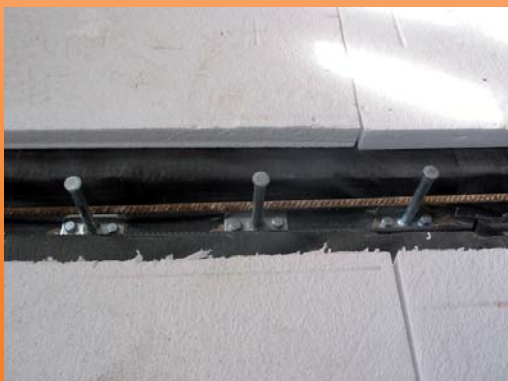
Per arrivare alle prestazioni richieste si è reso necessaria l'interposizione di pannello rigido isolante.
